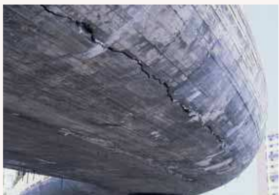
Zone vitale atteinte (dalle de tablier) par des désordres très intenses (présence d'une fracture et béton très dégradé).
