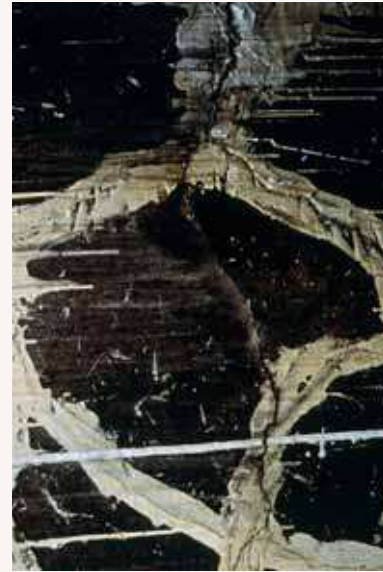
Fig. 2 – Fissure réapparaissant dans une zone injectée.
