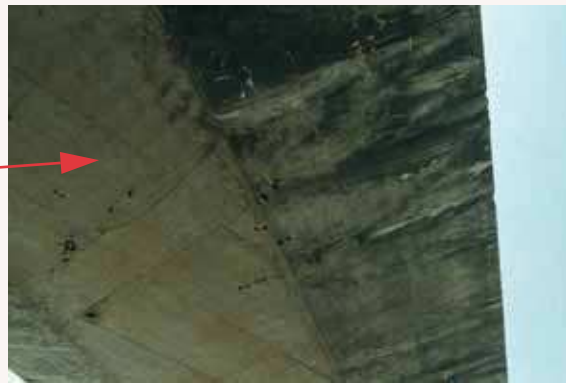
Vue de l'intrados fissuré de la travée centrale.
