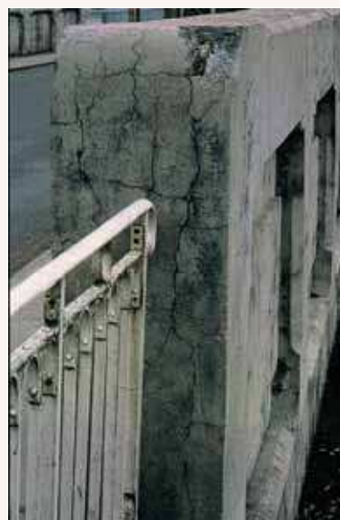
Détail de la fissuration de l'about d'une poutre longitudinale.
