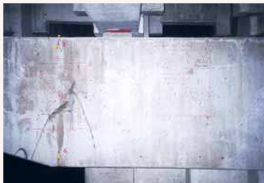
Zone vitale atteinte (chevêtre de pile marteau) par des désordres intenses (réseau de fissures).
