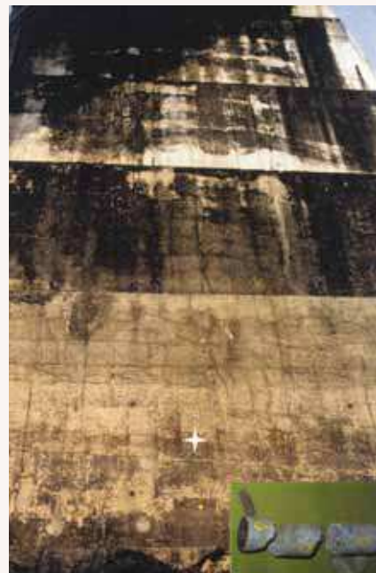
Fig 1 – Dégradations dues à l'alcali-réaction.
