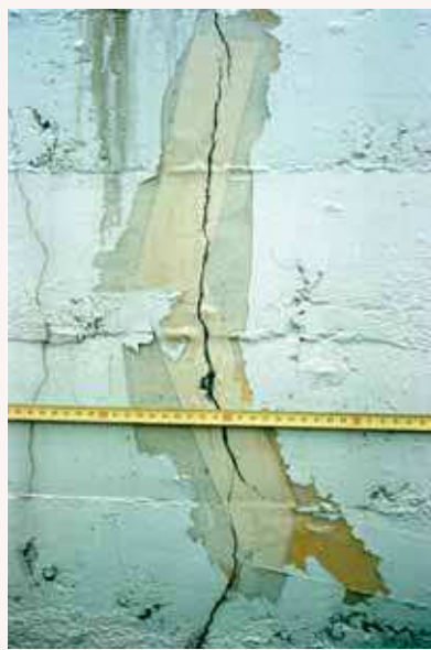
Fig. 4 – Pont suspendu : réapparition d'une fissure d'alcali-réaction injectée et cachetée quelques années auparavant.
