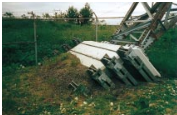
Fig. 3 - Massif d'appui d'un pylône d'une ligne à haute tension d'Hydro-Québec.
