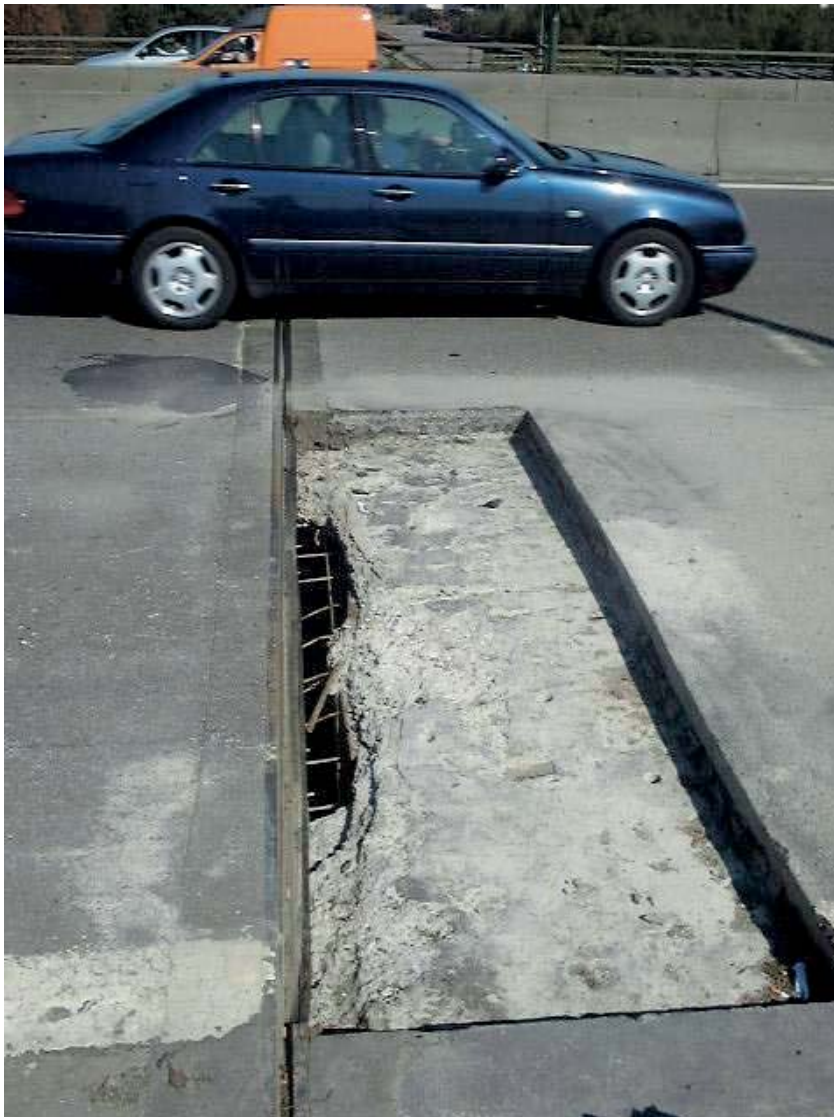
Fig. 2 - Viaduc autoroutier : formation d'un trou dans le tablier au droit d'un joint de dilatation.
