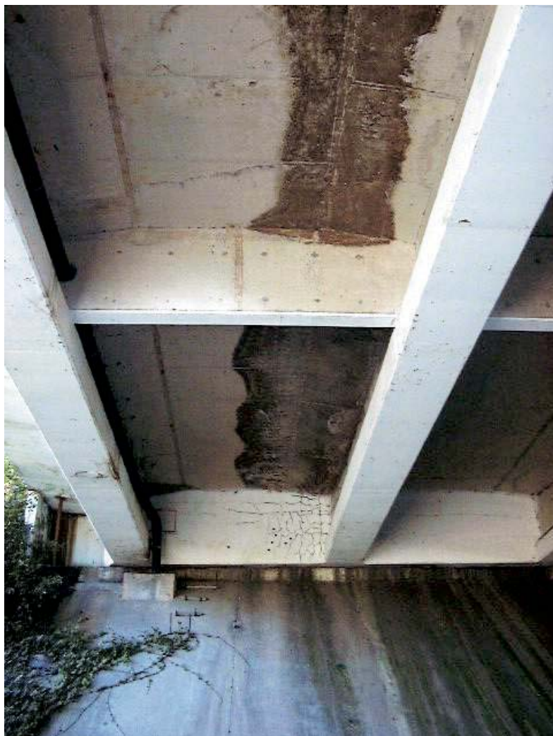
Fig. 6 - Vue de la face inférieure du tablier d'un pont autoroutier. Présence de taches foncées et persistantes malgré les conditions climatiques.
