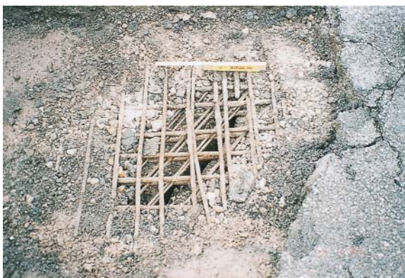
Fig. 4 - Pont routier : formation d'un trou dans le tablier au droit d'une dalle souple. Autour du trou, le béton est réduit à son squelette granulaire.
