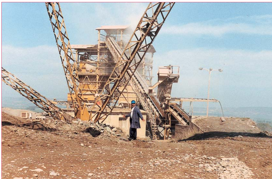
Fig. 5 - Exemple d'installation de carrière à l'est d'Alger.
