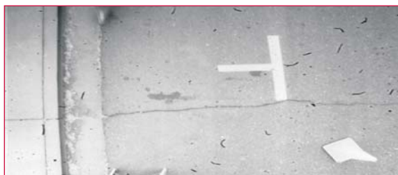
a. Image typique de fissure longitudinale sur une chaussée en béton.
