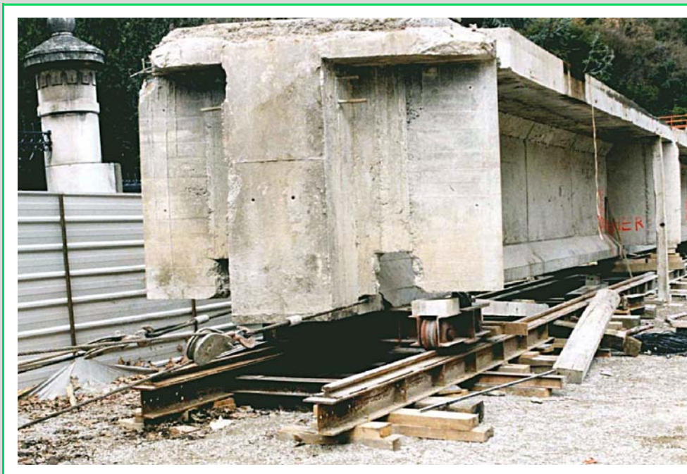
Fig. 1 - Poutre test avant autopsie.
