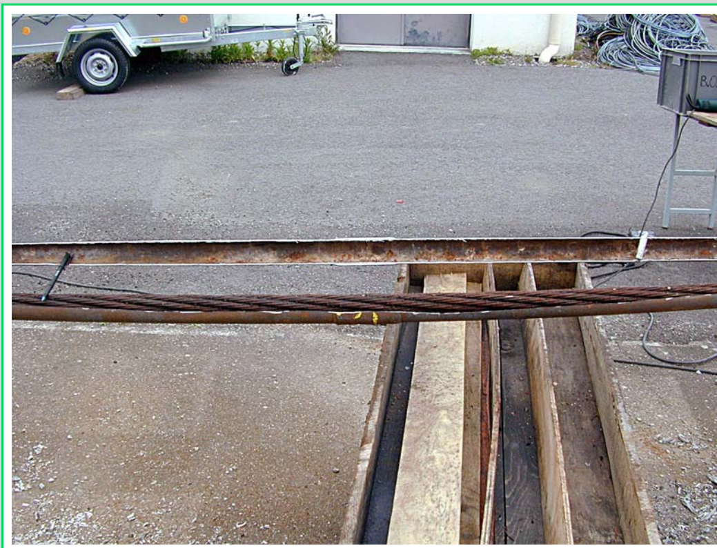
Fig. 9 - Exemple d'absence totale d'injection dans une gaine.
