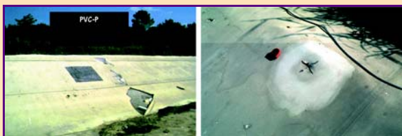
Fig. 1 - Vieillissement d'une géomembrane avec perte d'étanchéité.
