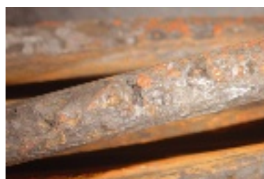
c) Acier corrodé. Plaques et cratères de dissolution.
