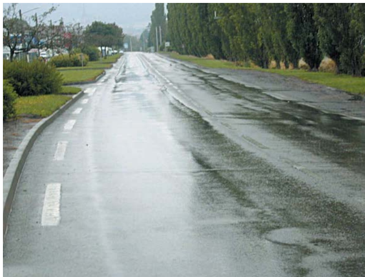
□ Figure 1 Irrégularités géométriques conduisant à de fortes accumulations d'eau.
