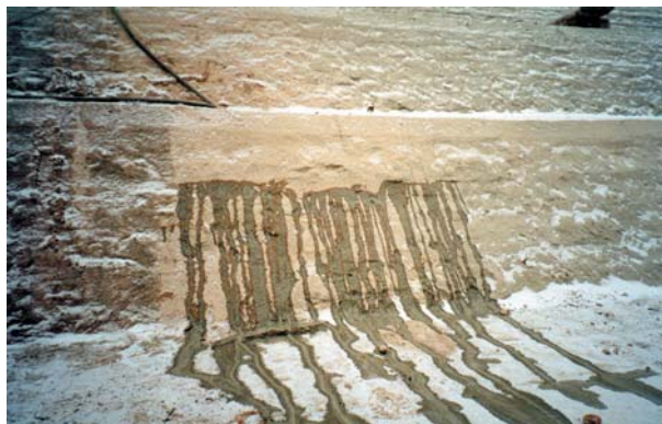
figure 17 Résurgences de coulis sur le talus amont.
