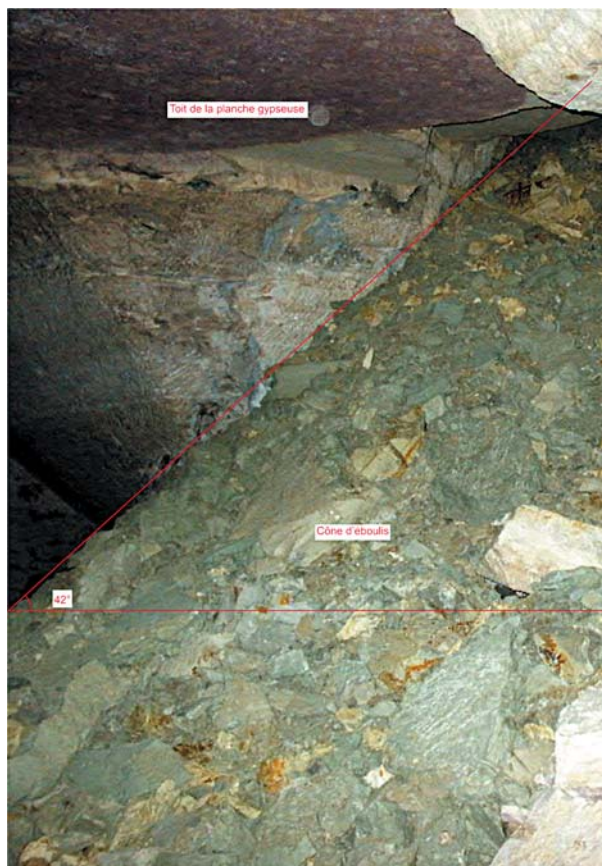
figure 13 Cône d'éboulis obstructif dans une carrière de gypse à parois verticales de la région parisienne composé essentiellement de blocs d'argiles très plastiques et de gypse tombé du ciel de la carrière. On observe la très bonne rectitude de la ligne de pente à un angle de 42 degrés par rapport à l'horizontale : hauteur de la carrière 5 m, diamètre du fontis 5 m (carrière de gypse à Evécquemont – 78).
