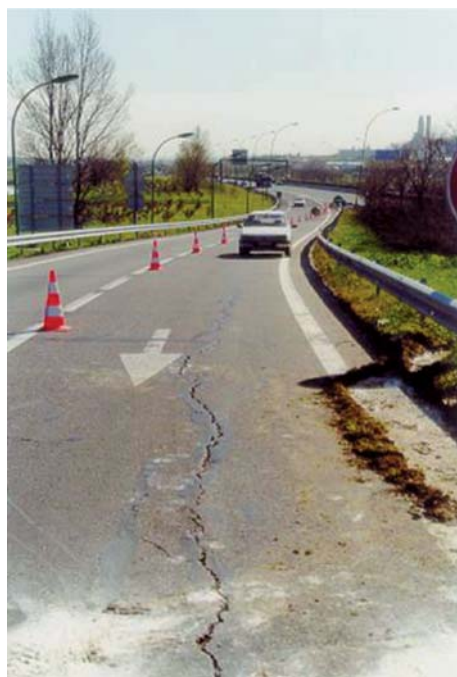
figure 13 Fissuration longitudinale dans un remblai en marne, attribuée aux effets des cycles d'humidification-séchage dans le talus (photographie C. Mieussens).
