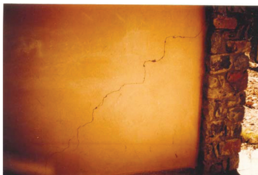
figure 14 Fissures dans un mur (Ejjaouani, 2008).
