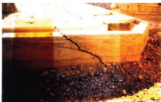
figure 15 Fissures dans une dalle (Ejjaouani, 2008).
