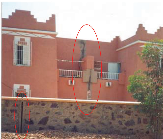
figure 16 Fissuration d'un mur et d'un bâtiment à Ouarzazate (Ejjaouani, 2008).
