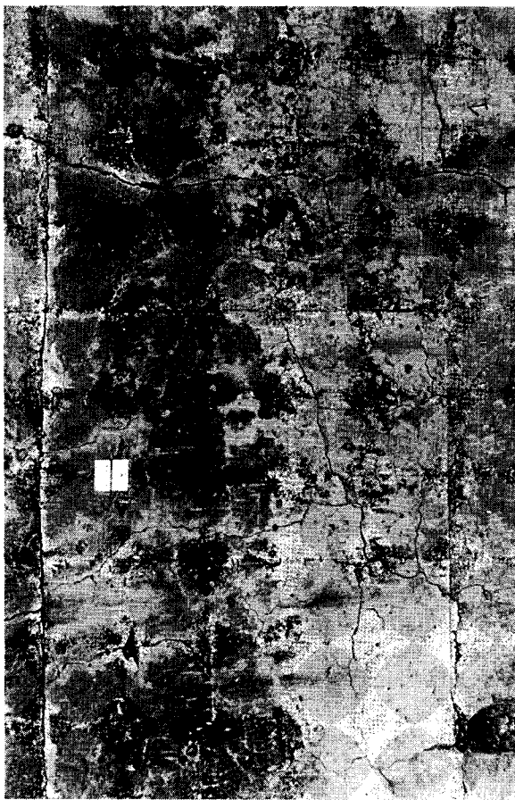
Fig. 3 - Mosaïque de fissures à la surface externe d'un mur en béton.
