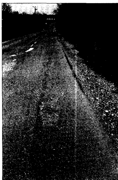
Dégradation de la chaussée.
