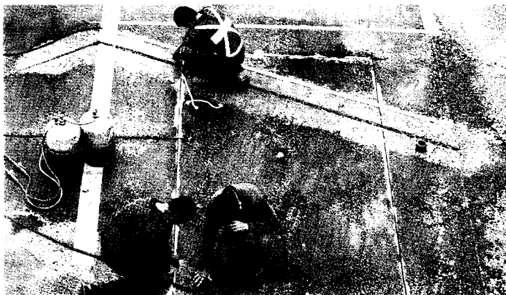
Fig. 11 - Installation de capteurs de trafic à fibres optiques sur un site test de la RN 10.
