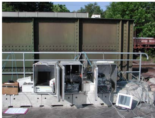
Figure 6.11. Systèmes d'acquisition utilisés pour la surveillance du pont d'Avesnes
