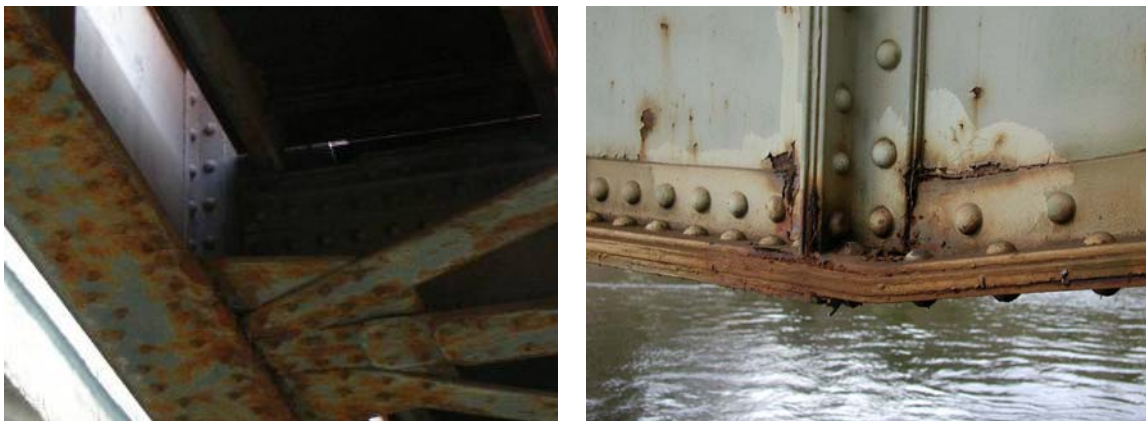
Figure 4.10. Exemples de traces de corrosion sur ouvrages
