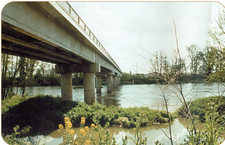
FIGURE 7 - Vue générale d'un pont dont l'un des chevêtre est atteint d'une RSI (France).
