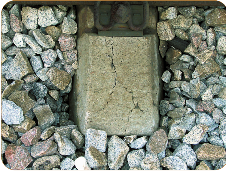
FIGURE 6 - Extrémité d'une traverse de chemin de fer présentant un réseau de fissures provoquées par une RSI (à l'étranger).
