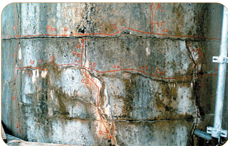
FIGURE 8 - Fissuration multidirectionnelle localisée sur la face verticale, aux extrémités d'un chevêtre du pont de la figure 7.
